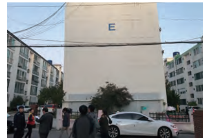
▲ 11·15 지진 피해 : 건축물 기울어짐
