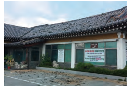
▲ 9·12 지진 피해 : 지붕 기와 떨어짐
